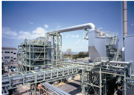
バイオマス発電設備全景
