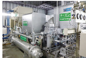
蒸気タービン発電機
