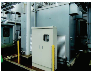
茨城工場のLPガス蒸気ボイラー
