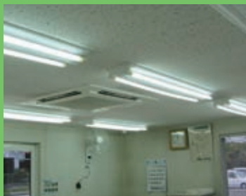
▲省エネ型照明機器への更新を推進しています(茨城工場)。
